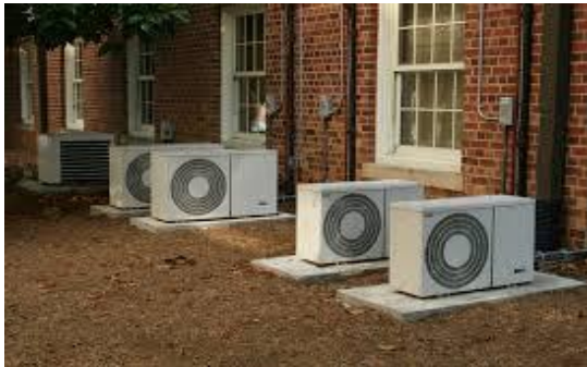
Fig. 1. Compressor vapor AC
